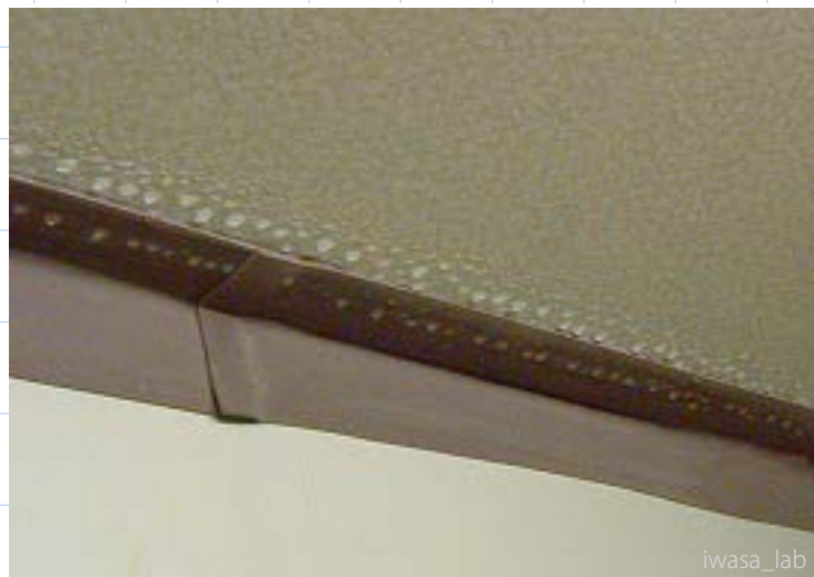
天井にも結露が発生する
